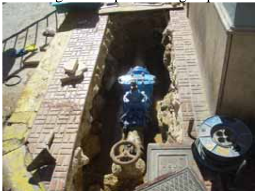
un dels nous sistemes de control i detecció de fuites en la xarxa d'aigua
