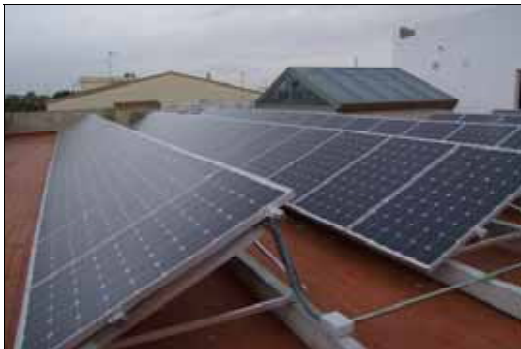
Les plaques de la nova central fotovoltaica en l'edifici del centre de dotacions
